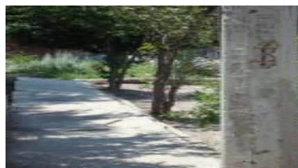
Fig. 12. Calle en mal estado, en calle M. Diéguez
